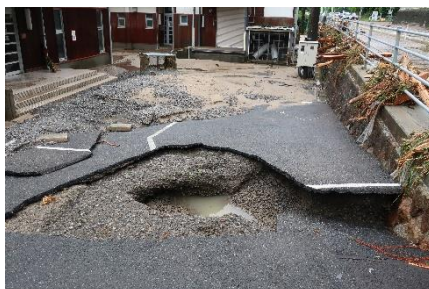
駐車場が崩壊した様子
