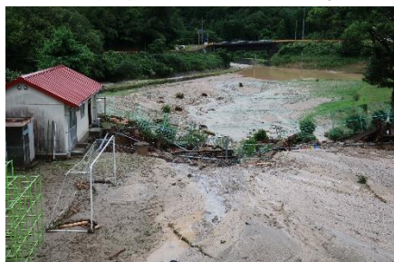
運動場が崩壊した様子
