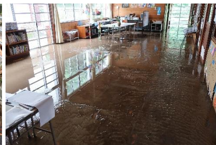
校舎内に床上浸水した様子
