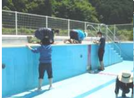
⑤側面、側溝も結構汚れていました。
